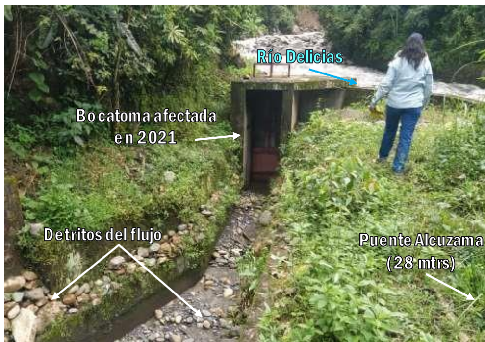
Fotografía 11. Bocatoma Afectada a pocos metros del lado derecho del puente Alcuzama (puente donde el río Delicias se convierte en el río Huacayoc)
