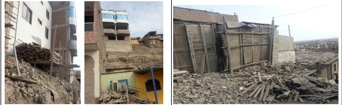
Se observan pirca inestable e inseguras sin usar mortero (arena Gruesa – Cemento), como material ligante y sin cimiento sobre terreno natural
