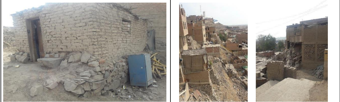
Se observan viviendas de adobe sobre pirca inestable e inseguras sin usar mortero (arena Gruesa – Cemento), como material ligante y sin cimiento sobre terreno natural
