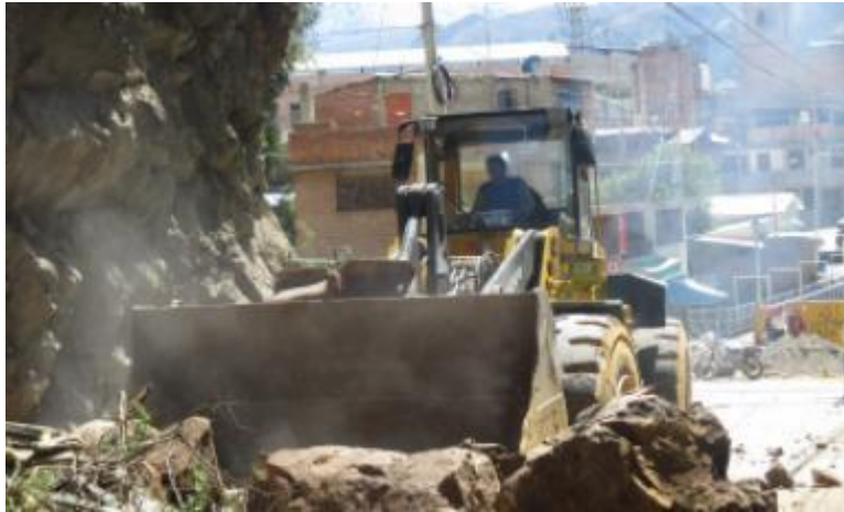
Zona crítica: Bloqueo de la vía de acceso al barrio de Los Olivos por derrumbe de piedras del cerro conocido como “Balcón de Judas”.
