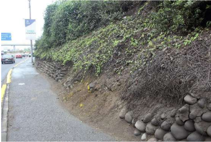
Figura 49. Vista de muro de protección deteriorado.
