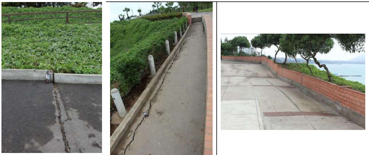
Figura 54a, b y c. Vista de grietas, fracturas y desniveles en infraestructura pública latente en la parte alta del acantilado de Miraflores
