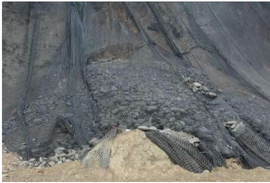
Figura 52. Vista de zona de estudio con mallas estropeadas por la acción de agentes externos.
