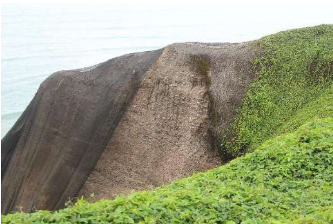
Figura 53. Zona expuesta sin geomallas ni cubierta vegetal
