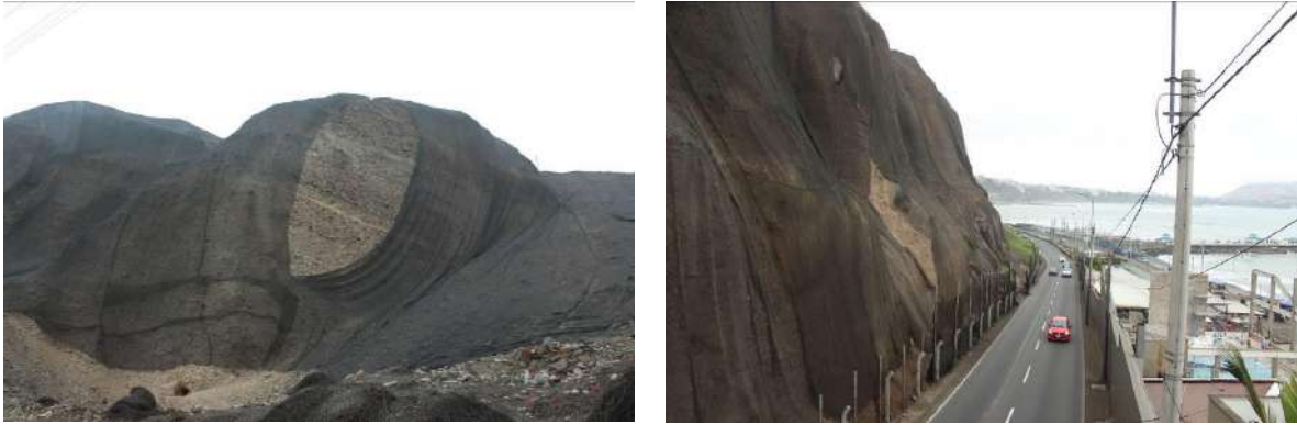
Figura 51a y b. Vistas de las geomallas descosidas en la Vía Costa Verde
