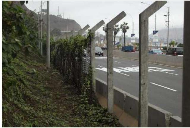
Figura 45. Vista de zona con caída de geomalla
