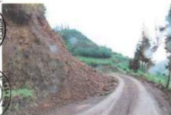
Figura N°09. Deslizamientos de terreno
