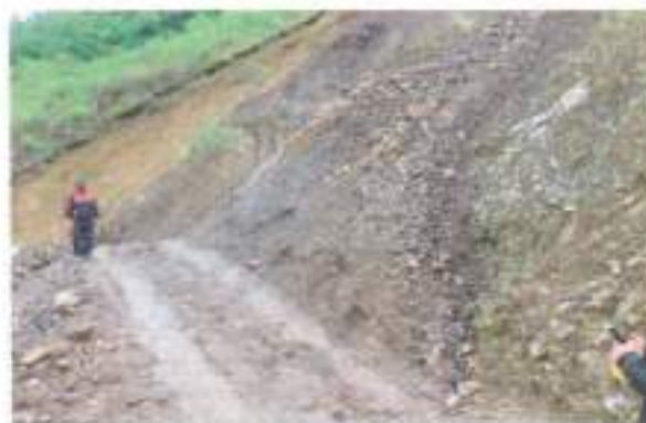
Figura N° 10. Deslizamientos de terreno en trochus
